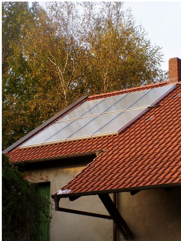
Abbildung 2: Solarthermie: Flachkollektoren zur Warmwasserbereitung und Heizungsunterstützung (Bildquelle: [7])
